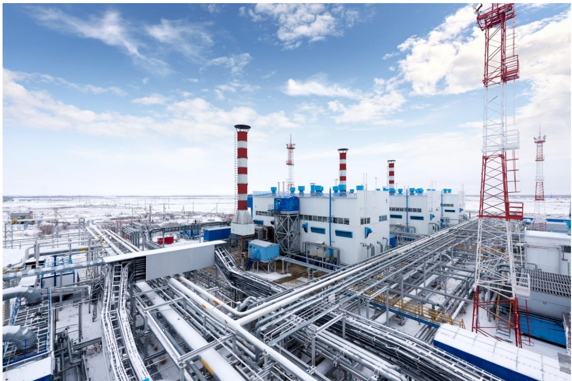
Компрессорная станция по утилизации попутного нефтяного газа на центральных пунктах сбора нефти ООО «Газпром добыча Уренгой»
